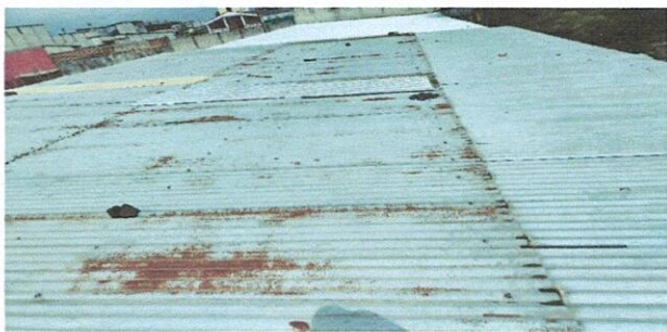
HONOR X7b 24mm f/1.75 1/1442s ISO100 Foto 3: laminas oxidadas y con oxido donde se filtra en agua.
