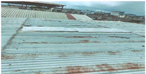
HONOR X7b 24mm f/1.75 1/1400s ISO100 Foto 4: Techo de lamina la cual se ve deteriorada por el paso del tiempo
