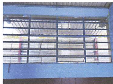
Foto 6: Mantenimiento de ventanas en mal estado
