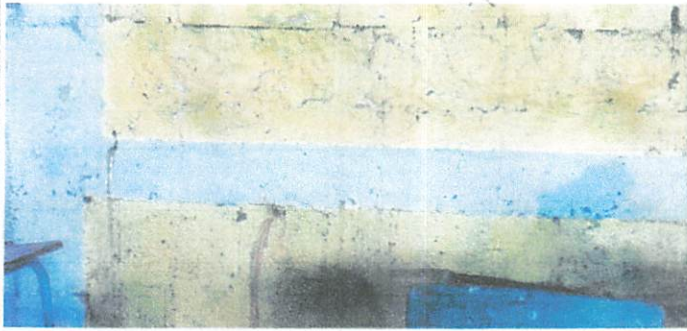
Foto 1: En esta parte de la pared salen heces y orina, ya que según indican que hubo un daño a la tubería de drenaje hace algunos años.
