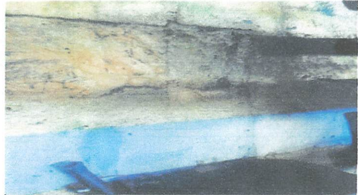
Foto 4: se observa en esta parte de la pared la construcción no es adecuada y correcta.
