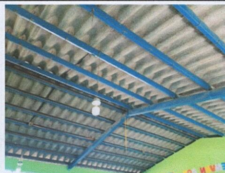
Foto 4: LA FOTOGRAFIA MUESTRA EL TECHO DEL SALON NUMERO 17 QUE TIENE PROBLEMAS DE RAJADURA POR PIEDRA Y EL CUAL ESTA TAPADO CON LAMINA PARA EVITAR LLUVIAS.
