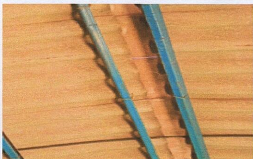
Foto 3: LA FOTOGRAFIA MUESTRA EL TECHO DEL SALON NUMERO 22 CON VARIOS PROBLEMAS DE RAJADURA EN EL TECHO Y COSTADOS.
