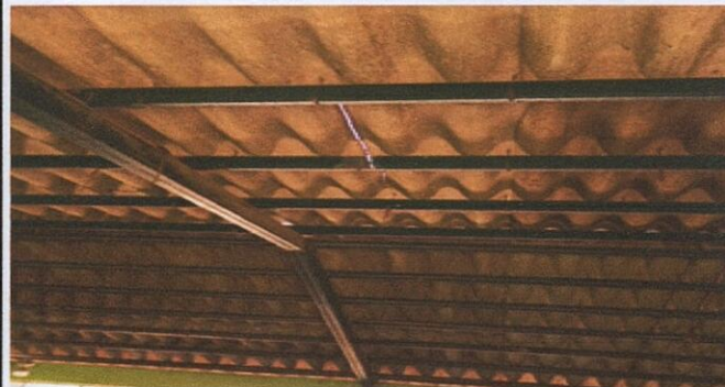
Foto 2: LA FOTOGRAFIA MUESTRA LA RAJADURA QUE TIENE EL SALON NUMERO 21 EN EL TECHO DE DURALITA.
