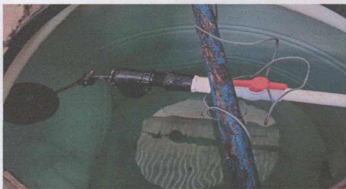
Foto 4: Cisterna de concreto ya que actualmente solo se cuenta con un tinaco rotoplas enterrado y por dentro ya se derrumbo y deforme el tinaco.
