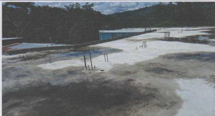
Foto 2: Ampliación de la red de bajadas de agua pluvial ya que solo se cuentan con 4 para toda la terraza y esto genera problemas en la terraza.
