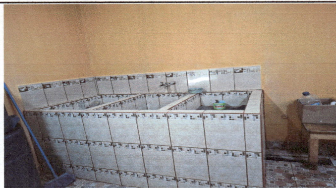
Foto 2: Revestimiento con azulejo en pila de la cocina.
