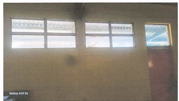
Foto 2: Colocar vidrios faltantes y quebrados en ventanas de cocina y comedor
