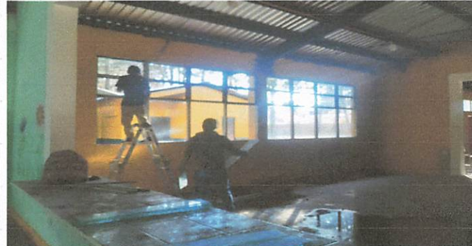
Foto 2: Colocar vidrios faltantes y quebrados en ventanas de cocina y comedor
