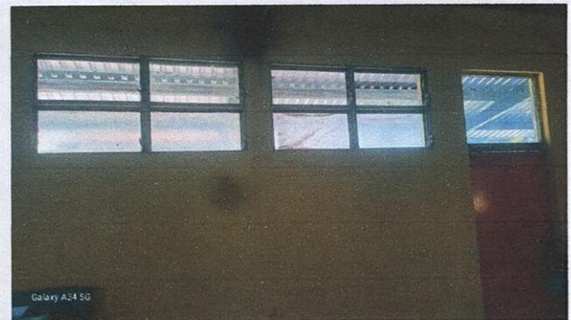
Foto 2: Colocar vidrios faltantes y quebrados en ventanas de cocina y comedor
