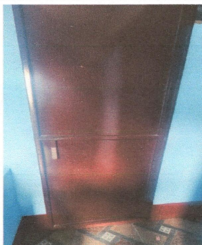
Foto 9: Sustitución de puertas de servicio sanitario sin chapa.
