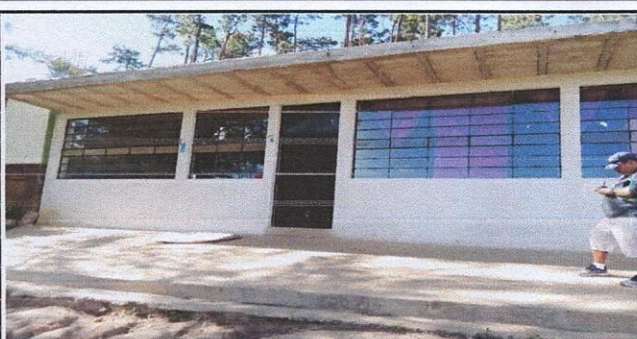
Foto 3: en la siguiente fotografía muestra la forma inclinada del patio donde se necesita teminar y corregir la losa del patio, el cual representa un peligro para la seguridad de los niños, al resbalarse pueden ir a
