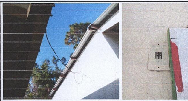
Foto 4: en la siguiente fotografía muestra la necesidad de aplicar el renglón de reparación del sistema eléctrico eléctrica ya que se encuentra inconcluso el cableado eléctrico, así como también la forma incorrecta de instalación, al mismo tiempo cambio de caja de filipones.
