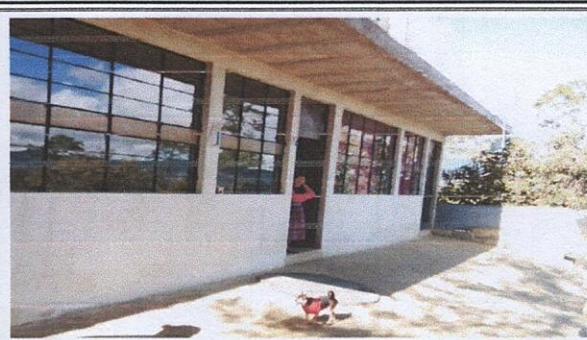
Foto 2: en la siguiente fotografía necesitamos terminar y corregir de acuerdo al renglón de losas de patio, ya que se encuentra muy inclinado y cuando los niños salen de los salones corren el riesgo de caerse.
