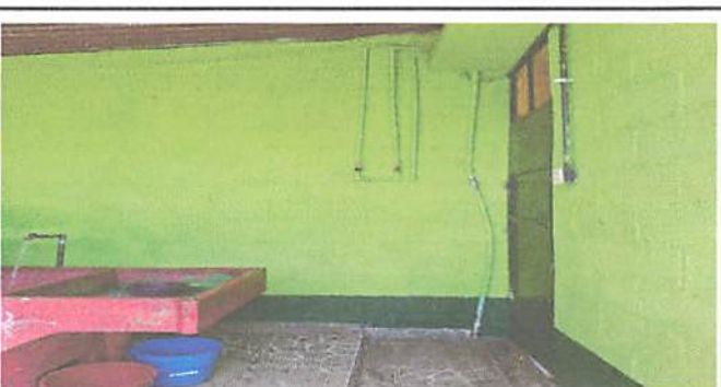
Foto 4: Tubería del cisterna al tinaco
