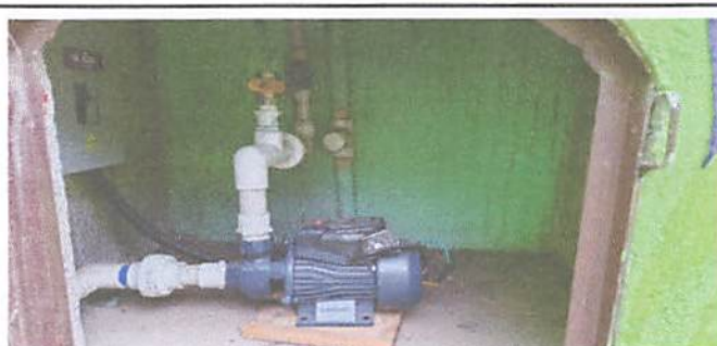
Foto 2: Bomba de agua actual
