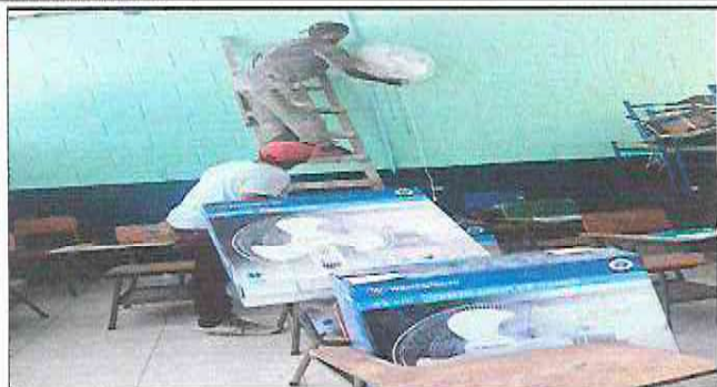
Sustitución de Ventiladores, 2 por aula que estan quemados
