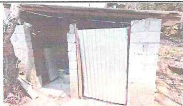
Foto 1: Los baños son letrinas y no cuentan con puertas seguras, repello ni cerrido, los niños y niñas usan el mismo, pues solo 1 tiene puerta.
