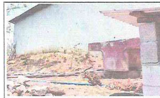
Foto 6: La única pila que hay en el NUFED, ya no se ocupa, pues la poca agua que llega se escapa por las rajaduras de la misma.
