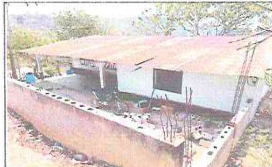
Foto 2: El aula que estaba en proceso, parte de la pared colapsó, pues no hay recursos para terminar de fundir las columnas.
