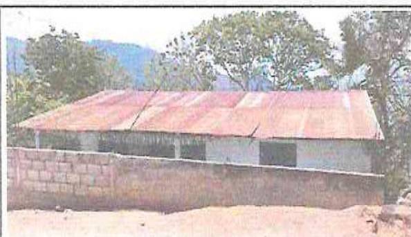
Foto 3: El techo está en mal estado y en el invierno, afecta a los estudiantes.
