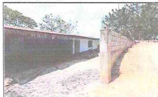
Foto 4: El muro perimetral se ha deteriorado, debido a la presión que ejerce la tierra del barranco y la vibración de camiones al pasar.
