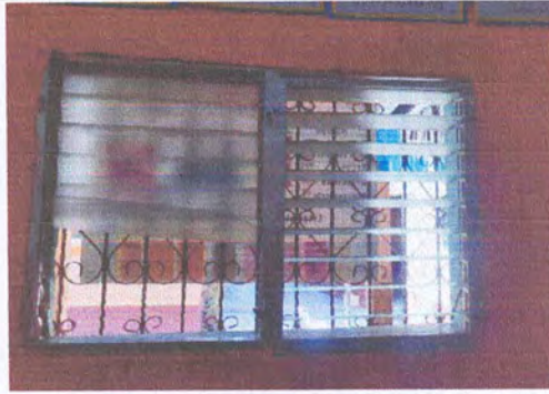
Foto 2: Sustrucción de paletas de vidrio en ventanas de una aula
