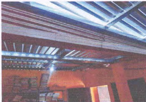
Foto 13: Sustrucción de soporte o pescante de metal para canal
