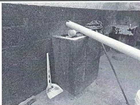
Foto 4: lavamanos de concreto dañado, muro sin acabado y piso dañado.
