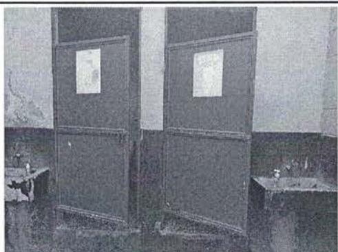
Foto 3: puertas en mal estado y lavamanos dañados, se construira mueble para instalar 4 lavamanos.
