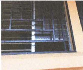
Pintura en general de barandales
