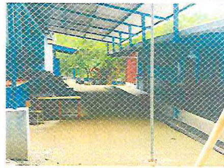
Foto 8: Protección para tubos de bajada pluvial
