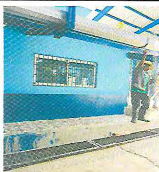
Foto 8: Protección para tubos de bajada pluvial
