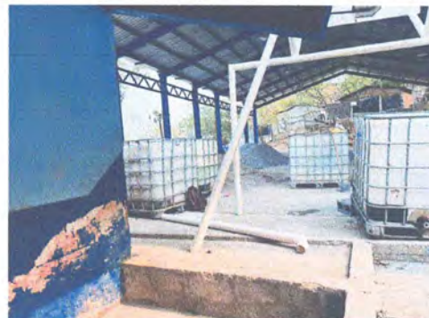
Foto 8: Protección para tubos de bajada pluvial
