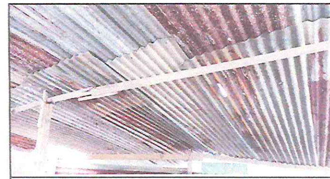
Foto 6: Estructura de madera del techo del aula, se encuentra en mal estado (madera picada y renglones quebrados), poniendo en riesgo la vida de los estudiantes.
