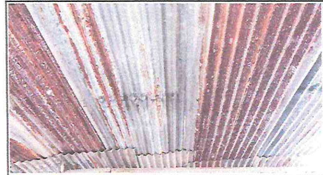
Foto 4: Lamina oxidada y con agujeros, que pone en riesgo la vida de los estudiantes y al momento del invierno no los protege de la lluvia.
