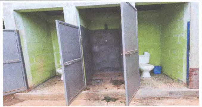
Foto 14: PINTURA EN BAÑOS
