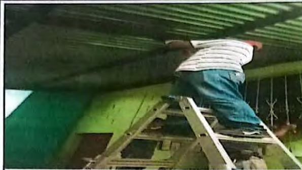
Foto 13: Sustitución de lámparas tipo LED
