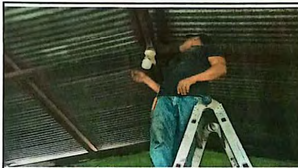
Foto 15: Instalación de unidades luz
