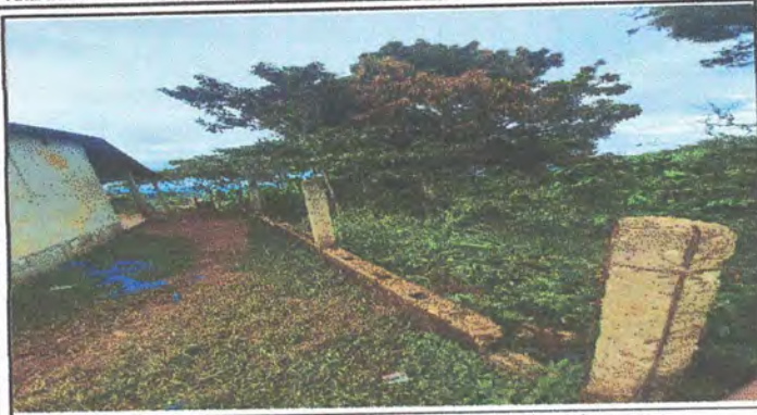
Foto 1: En esta fotografía se muestra que no tiene la malla y las columnas se encuentran en malas condiciones, porque el hierro ya está corroído y ya no soporta la malla, por ese motivo se van a demoler, solo las columnas en mal estado
