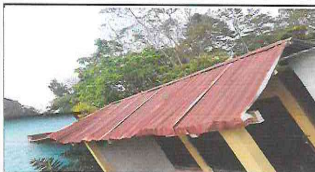
Foto 3: Cambiar lámina por lámina troquelada alucin calibre 26 y estructura de madera por estructura metálica.
