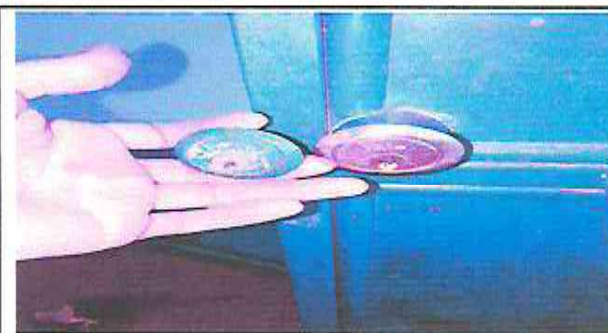
CAMBIO DE CHAPA DE PUERTA DE AULA2
