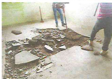
Foto 1: Se aprecia el levantamiento de la torta que estaba en mal estado
