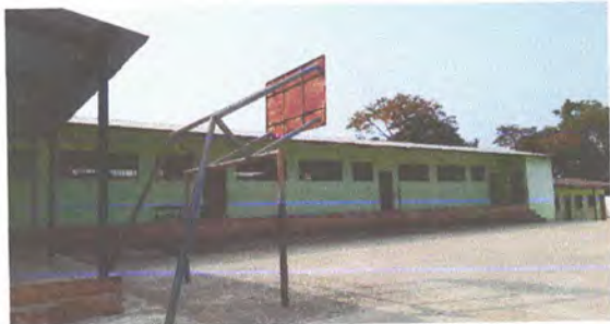
Foto 7: se aprecia el deterioro de la pintura de la parte exterior de la escuela
