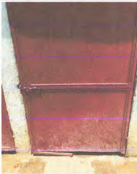
Foto 3: Se aprecia el deterioro de algunas puertas de los modulos
