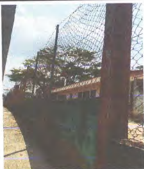
Foto 9: se aprecia el deterioro del muro por la parte de adentro del centro educativo
