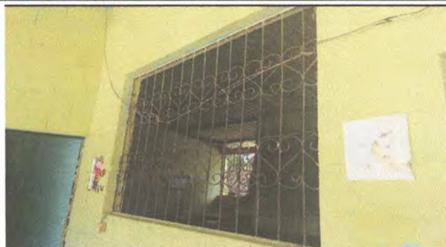
Foto 2: Sustrucción de balcon de metal por metal por deterioro
