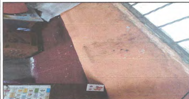
Foto 5: Sustrucción de pintura por deterioro natural
