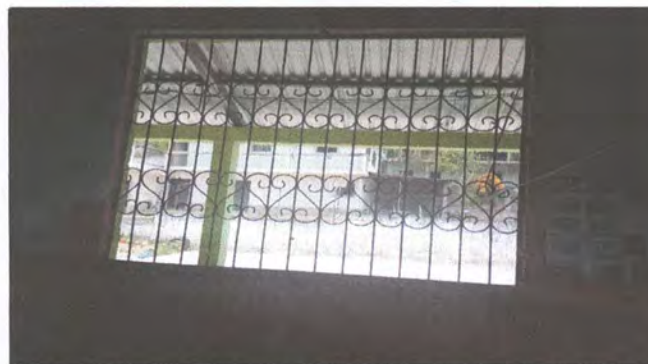
Foto 4: Sustrucción de balcon de metal por metal por deterioro natural
