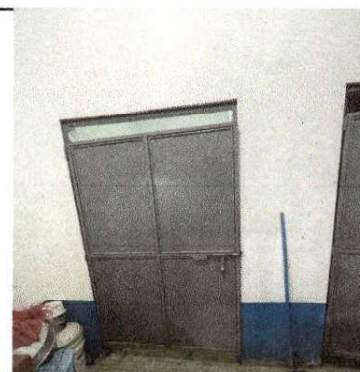
Foto 10: Módulo C, Puertas con pintura deteriorada
