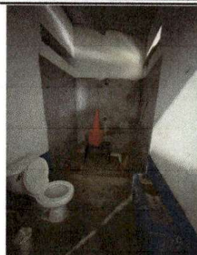
Foto 8: Módulo C, sanitarios descompuestos
