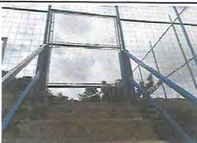
Foto 1.2 Puerta con maya metalica de 2"1
