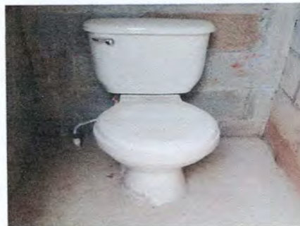
Foto 10: Servicio sanitario ya instalado
