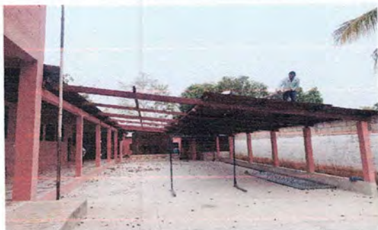
Foto 9: Sustrucción de lámina en mini cancha
