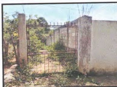
Foto 20: Cernido en muro perimetral
