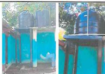
Foto 4: ESTRUCTURA METALICA PARA TANQUE ELEVADO.
