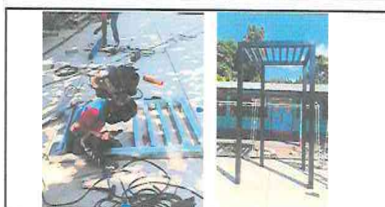
Foto 4: ESTRUCTURA METALICA PARA TANQUE ELEVADO.
