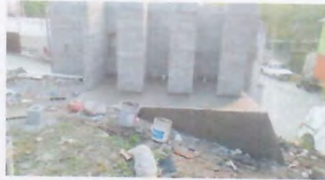
Foto 8: TORTA DE CEMENTO EN EN SERVICIOS SANITARIOS
