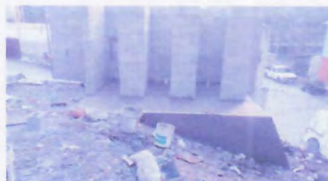
Foto 8: TORTA DE CEMENTO EN EN SERVICIOS SANITARIOS
