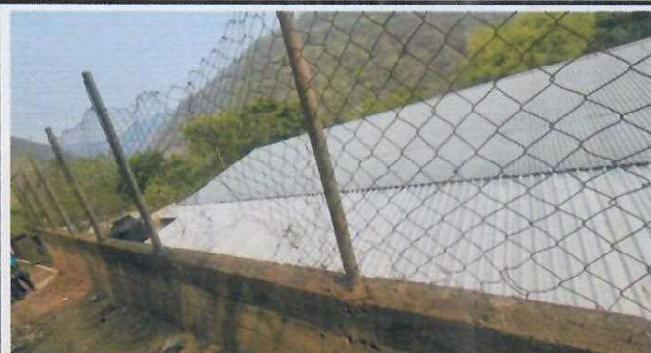
Foto 2: Área que necesita reparación de tubo hg y malla galvanizada. Será sustituida.
