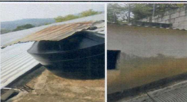
Foto 3: recipiente de agua sin protección, en mal estado y sin tapadera, éste será sustituido y con mejoras para su protección
