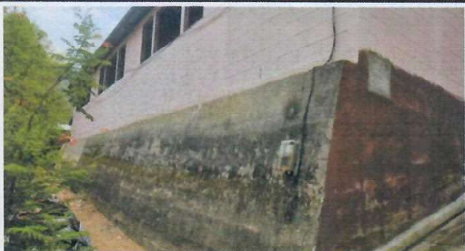
Foto 1: Necesidad de pintura en muros exteriores e interiores. Se pintará en su totalidad
