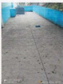
Foto 3: Drenaje para aguas pluviales
