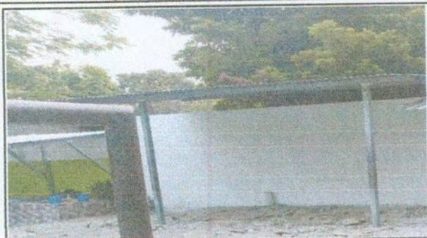
Foto 7: CERNIDO EN MURO PERIMETRAL
