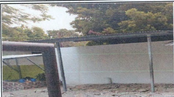
Foto 7: CERNIDO EN MURO PERIMETRAL
