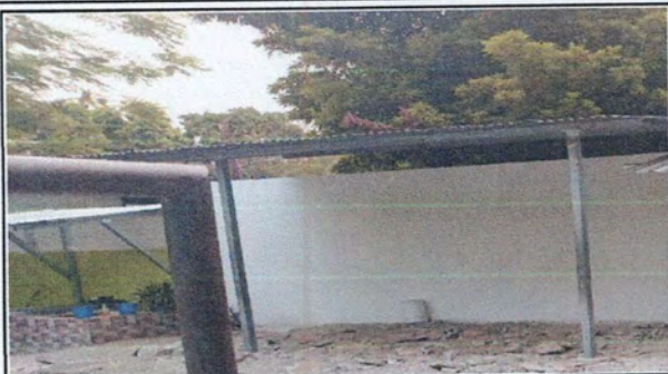
Foto 7: CERNIDO EN MURO PERIMETRAL
