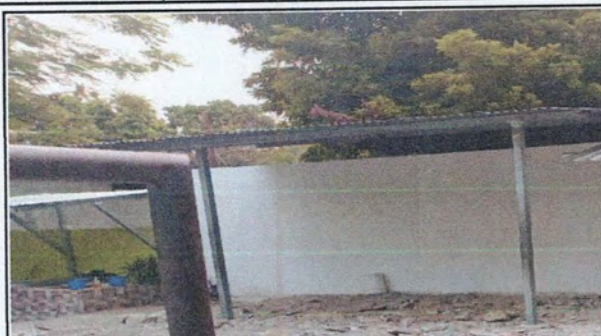
Foto 7: CERNIDO EN MURO PERIMETRAL
