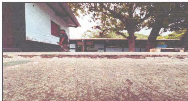
Foto 11: PISO DE CEMENTO EN CANCHA QUE NECESITA REPOSICION, (DEMOLICION DE 15 CM DE PLANCHAS EXISTENTES)
