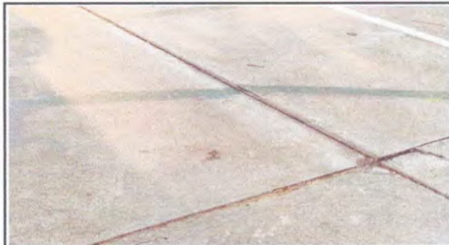
Foto 10: PISO DE CEMENTO EN CANCHA QUE NECESITA REPOSICION, (DEMOLICION DE 15 CM DE PLANCHAS EXISTENTES)
