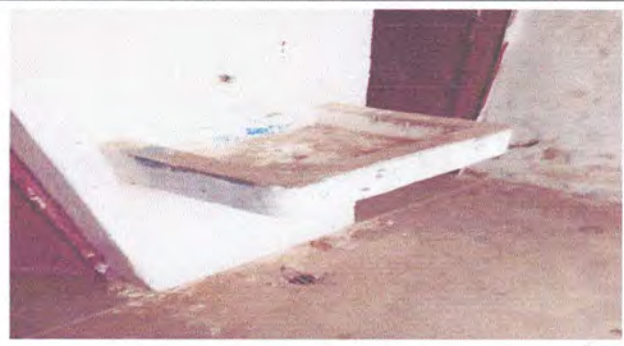
FOTO 17: LAVAMANOS QUE REQUIERE SUSTITUCION
