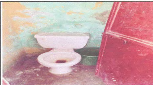
FOTO 2: INODORO QUE NECESITA CAMBIO
