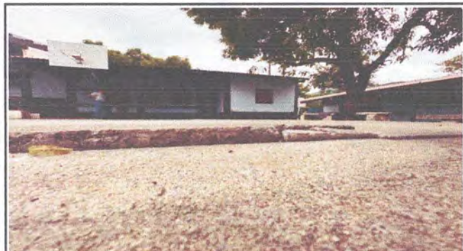
Foto 9: PISO DE CEMENTO EN CANCHA QUE NECESITA REPOSICION, (DEMOLICION DE 15 CM DE PLANCHAS EXISTENTES)
