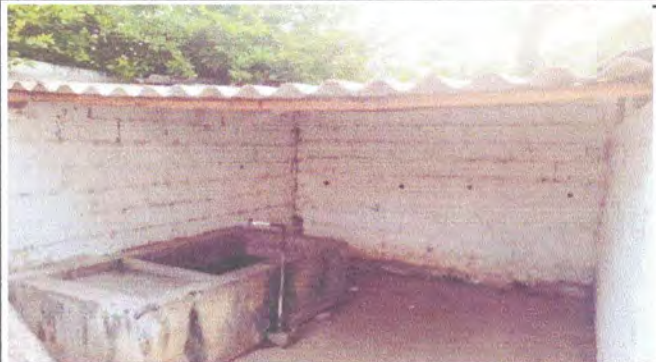
Foto 1: ESTRUCTURA DE MADERA QUE NECESITA CAMBIO Y REPARACION DE MURO
