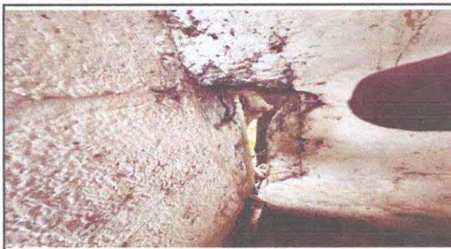
FOTO 8: DAÑAS EN MURO QUE NECESITA SER SUSTITUIDO
