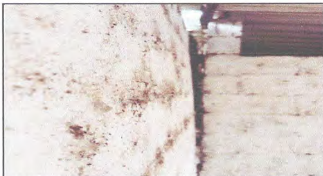
FOTO 7: MURO QUE NESECITA SER SUSTITUIDO.
