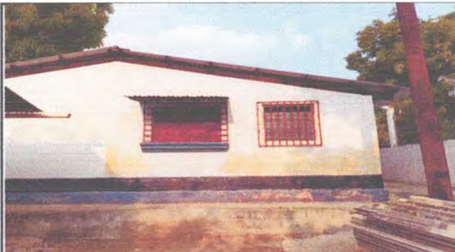
FOTO 4: VENTANAS DAÑADAS QUE SERAN CAMBIADAS
