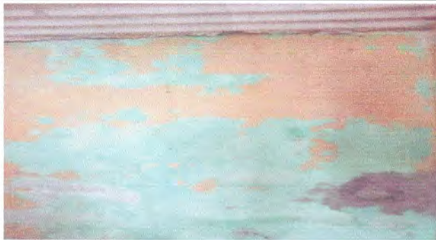
FOTO 16: MURO QUE REQUIERE CERNIDO
