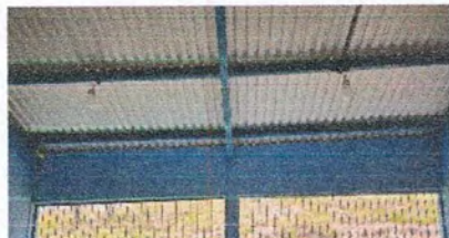
Foto1: Luminarias del aula.
