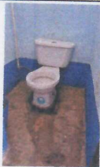
Foto 1: SERVICIO SANITARIO A REPARAR
