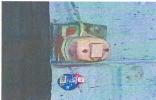
Foto 3: Sustrucción de interruptores.
