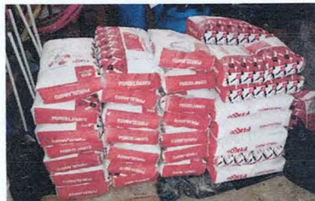
Foto 2: Bolsas de pegamento piso sobre piso para la instalación de piso cerámico en aulas.
