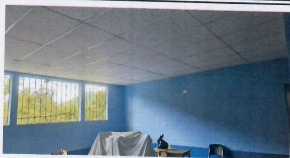
Foto1: PINTURA EN MUROS EXTERIORES E INTERIORES EN MAL ESTADO
