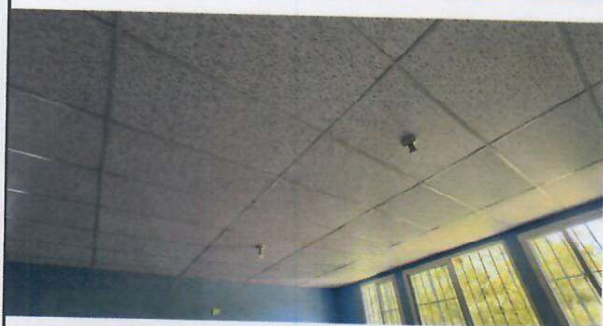
Foto 3: DUCTO QUE NECESITA CAMBIO
