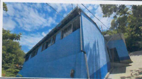
Foto 6: MURO DE CONTENCIÓN DE AULAS QUE NECESITA SABIETA
