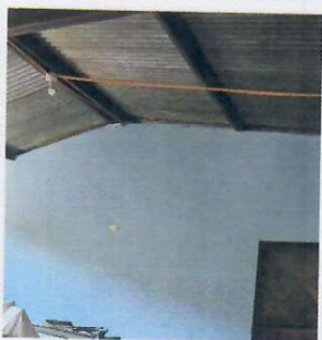
Foto 3: DUCTO QUE NECESITA CAMBIO
