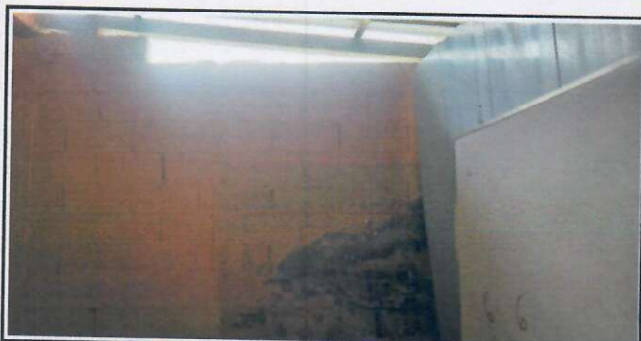
FOTO 5: PAREDES QUE NECESITAN REPELLO Y CERNIDO
