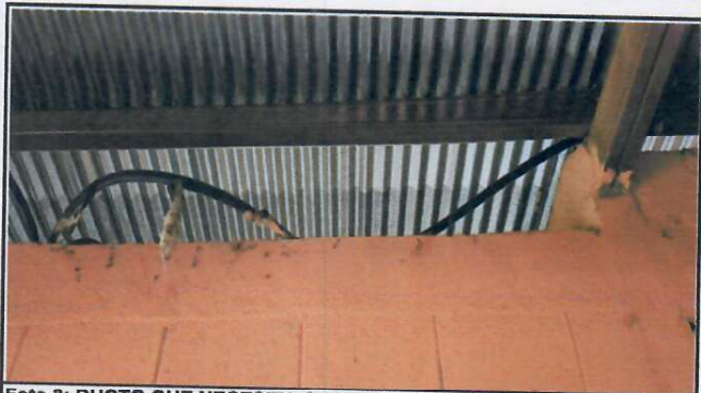
Foto 3: DUCTO QUE NECESITA CAMBIO
