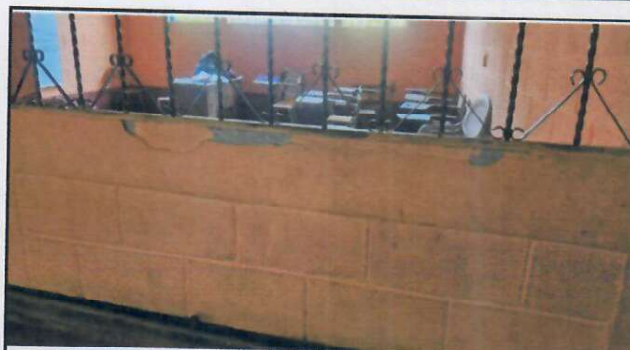
FOTO 4: PAREDES QUE NECESITAN REPELLO Y CERNIDO
