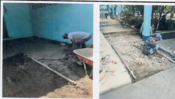
Foto 16: (PATIO) Se evidencia la sustitución de planchas de concreto, ingreso de baños y frente al depósito de agua.
